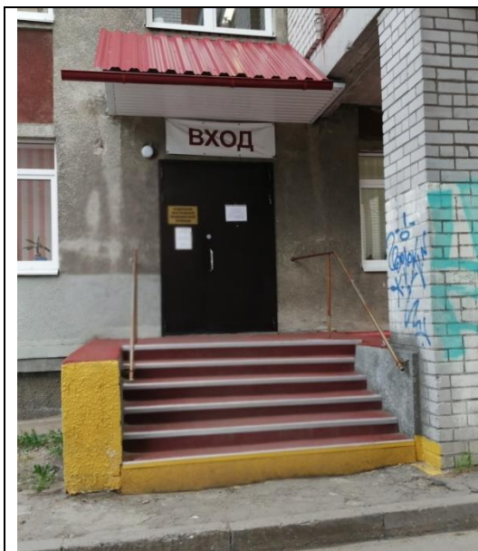
ГБУЗ АО «Архангельская городская клиническая поликлиника № 1», отделение неотложной медицинской помощи Адрес: г. Архангельск, просп. Троицкий, д. 99 (вход со двора) Результаты (состояние объекта): отсутствует пандус, подъемное устройство, кнопка вызова
