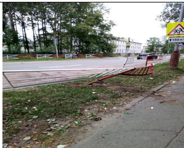
г. Новодвинск, ул. Космонавтов д. 5 (забор после аварии) (17.08.2021)
